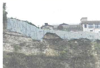
▲ 令和4年3月の地震により崩落した向山地区のモルタル擁壁
