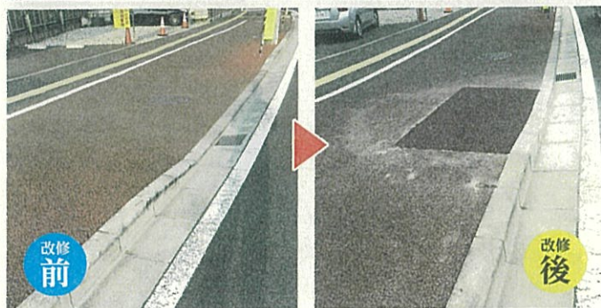
▲左折する際縁石の幅が狭くタイヤが乗り上げていた、拡張して解消
