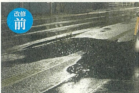
▲歩道の凹みが激しく水溜りができる
