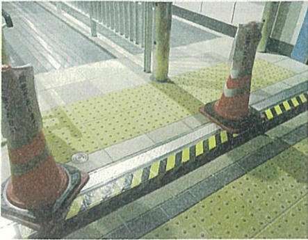
▲改修前 5cm の段差
