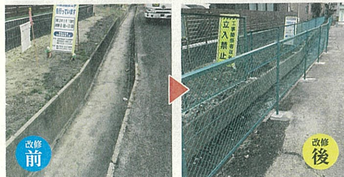
▲から堀で子供がはねて遊び危険な状態、防護柵を設置し安全確保
