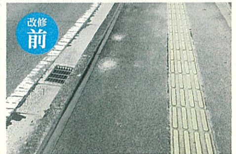
▲歩道の凹みが激しく通学に支障
