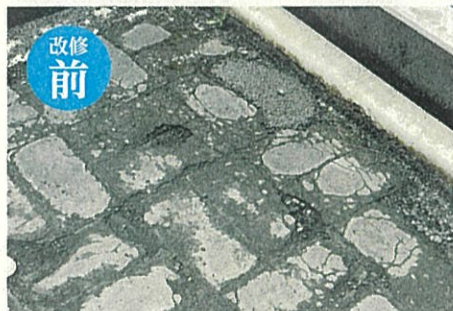
▲ボロボロに劣化したコンクリート
