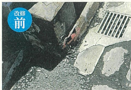
▲基礎部分の老朽化
