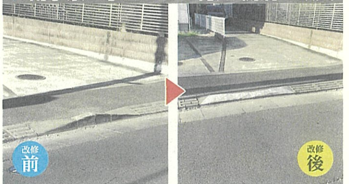
▲道路側溝に突起物があり、出入りにくいとの要望があり、道路課で突起部分を削除し、安全を確保しました。
