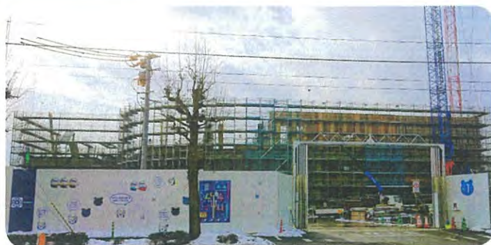
仙台徳洲会病院は、泉区高玉町に移転新築工事中。 完工は令和4年1月末の予定です。
