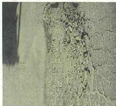
(袋原道路陥没)
