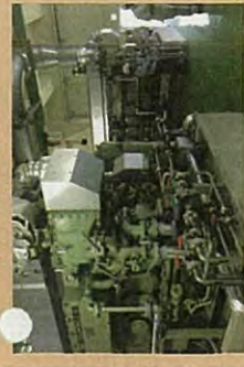
(写真 稼働中のポンプ2機)
