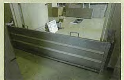
写真③ 建屋内電気室前止水板
