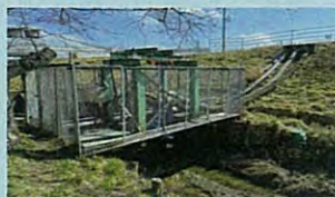
中野新町集会所裏排水ポンプ (白鳥二丁目)
