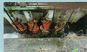
向田集会所裏排水ポンプ (高砂二丁目)
