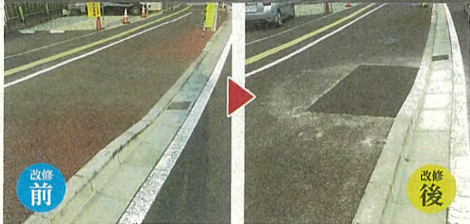
▲左折する際縁石の幅が狭くタイヤが乗り上げていた、拡張して解消
