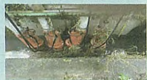
向田集会所裏排水ポンプ (高砂二丁目)
