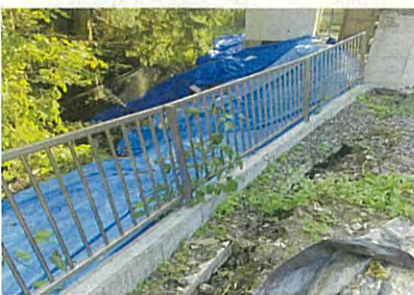
太白3丁目佐藤宅のり面崩落
