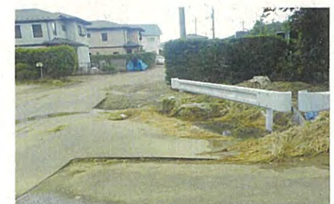
富田八幡中地区市道舗装破損
