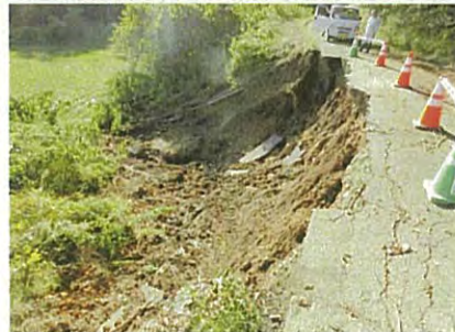
坪沼板橋地区市道のり面崩落
