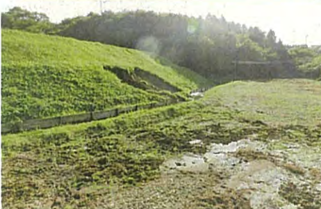
坪沼北地区農地のり面崩落
