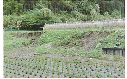
茂庭字梨野高田水田のり面崩落
