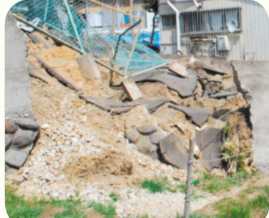
太白区青山地区の宅地被害
