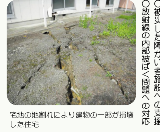
宅地の地割れにより建物の一部が損壊した住宅
