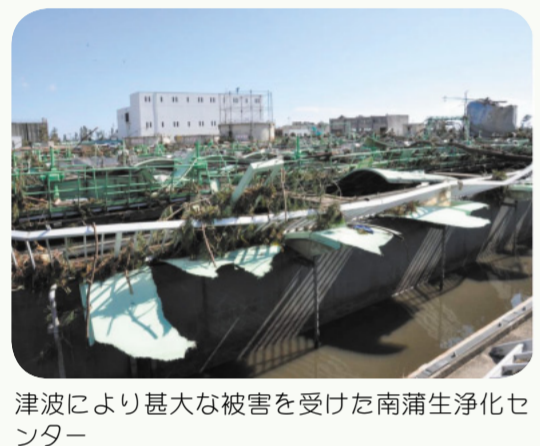
津波により甚大な被害を受けた南蒲生浄化センター
