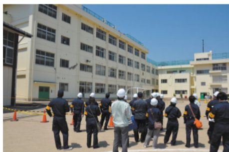
校舎外壁の亀裂から鉄筋が露出している 西多賀小学校
