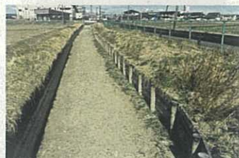
路肩・水路削れの緊急対応
