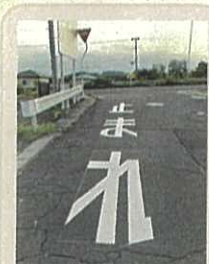
鉤取3丁目14付近(八木山南小通学路)の「止まれ」路面標示
