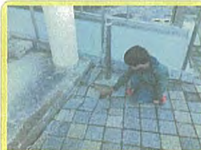
2月13日に発生した福島県沖での地震被害調査。袋原市営住宅では階段脇のコンクリート製敷材部分が陥没発生。
