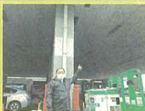
2月13日に発生した福島県沖での地震被害調査。仙台市中央卸売市場資材置き場天井落下状況調査(写真右)、及び太白区内の被害調査(写真左)。
